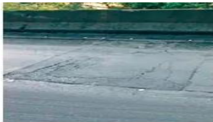
Figura 5. Trincas de retração
