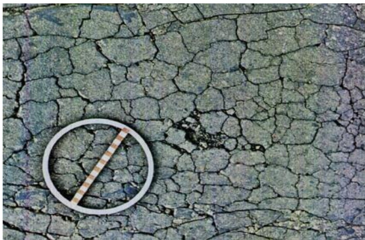
Figura 6. Trincas couro de jacaré
