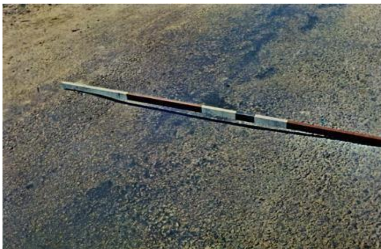
Figura 9. Afundamento por consolidação
