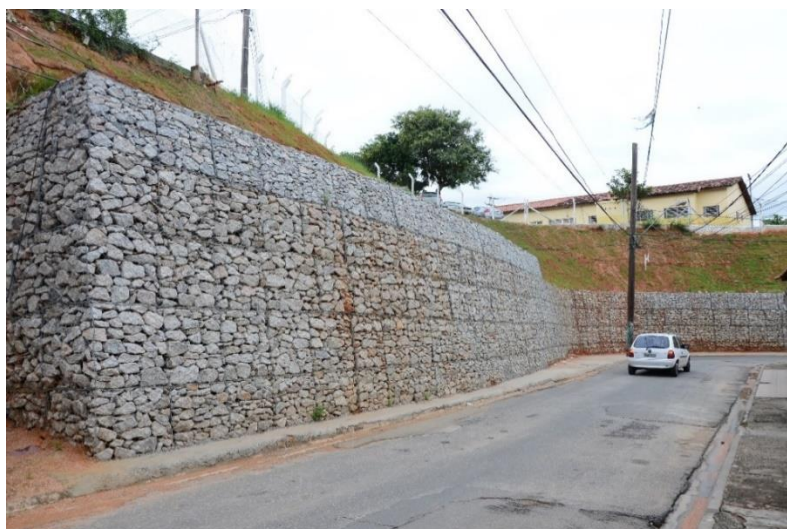
Figura 10. Muro de Gabião em área residencial.
