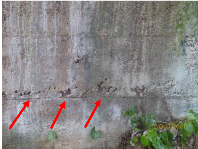
Figura 18. Falha na execução – Cortina - Concreto segregado. (seta vermelha).
