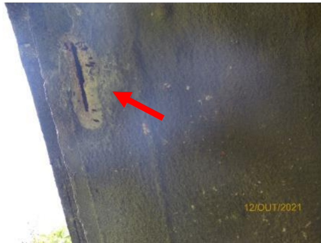
Figura 16. Patologia química – Laje - Concreto Desagregado e Armadura Exposta. (seta vermelha)
