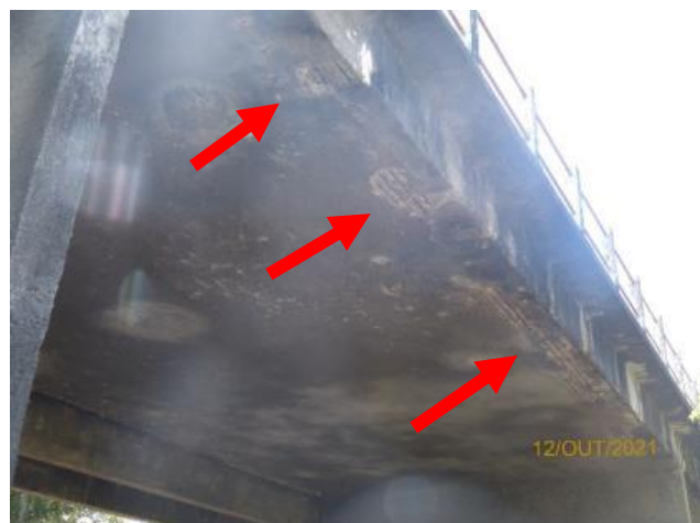
Figura 17. Patologia química – Laje Concreto Desagregado e Armadura Exposta. (seta vermelha)
