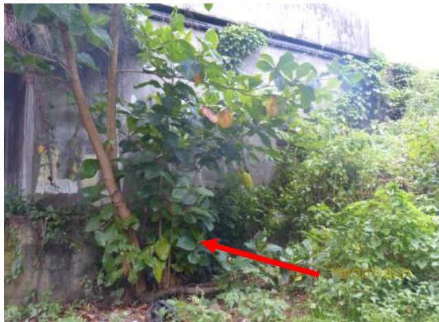
Figura 21. Patologia biológica – Muro de Ala Presença de vegetação nativa (Seta vermelha)
