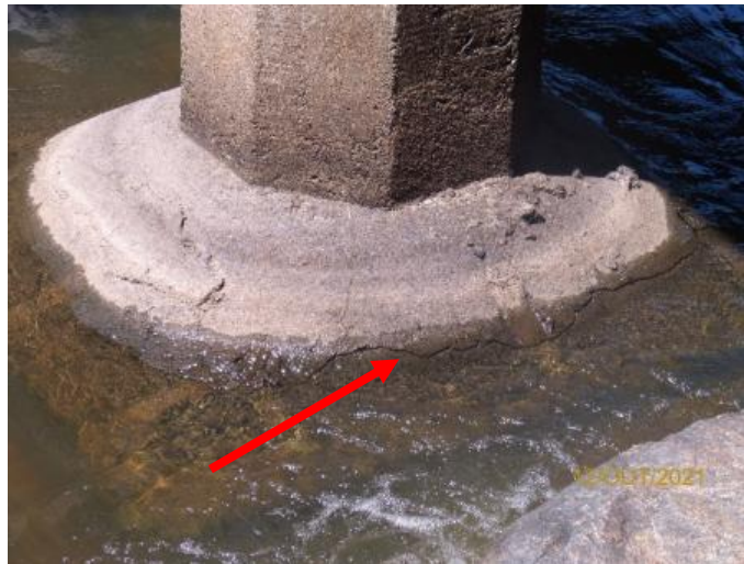
Figura 19. Patologia física – Bloco de fundação / Trinca (Seta vermelha)
