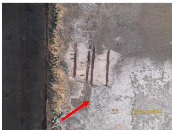
Figura 20. Patologia química - Laje - Eflorescência (Seta vermelha)
