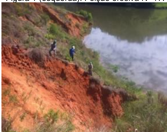
Figura 1 (esquerda). Feição erosiva Nº 17.
