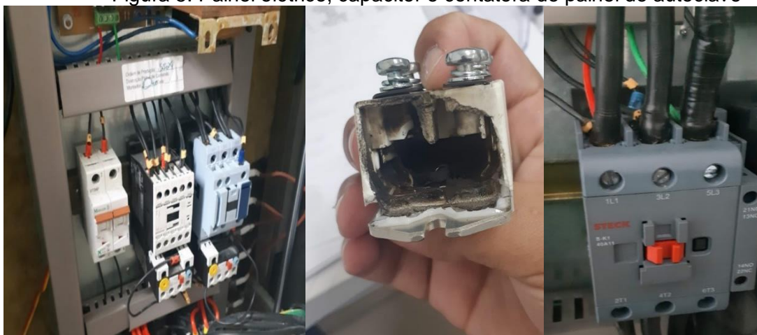
Figura 5. Painel elétrico, capacitor e contatora de painel de autoclave
