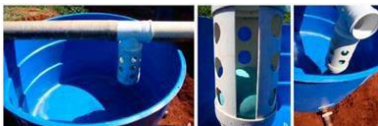
Figura 10. Reservatório de Descarte
