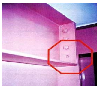
Figura 5. Falta de parafusos na conexão.
