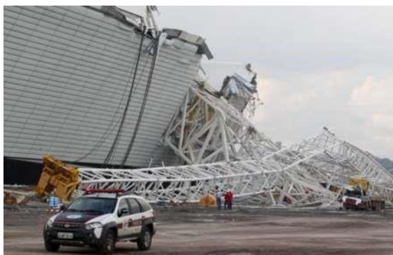
Figura 4. Acidente com viga metálica no processo de montagem.
